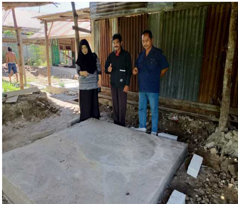
Gambar 4. SPAL yang Sudah jadi
